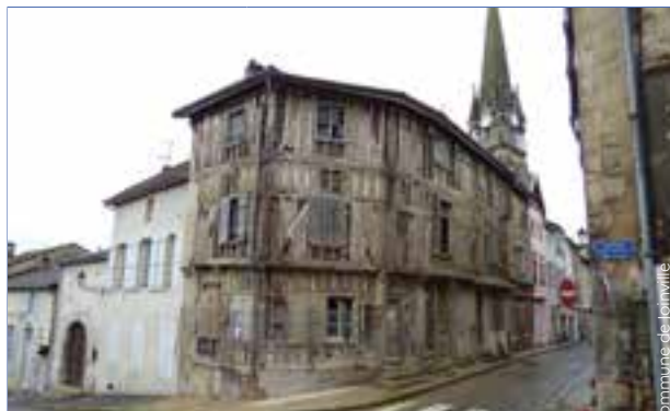
Habitat dégradé faisant l'objet d'une ORI
