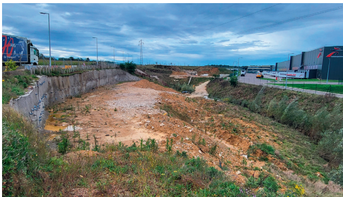
Au printemps par exemple, l'accès routier à la nouvelle base Intermarché perchée sur le plateau s'est affaissé, demandant un renforcement conséquent du soutènement et la circulation est depuis alternée.
